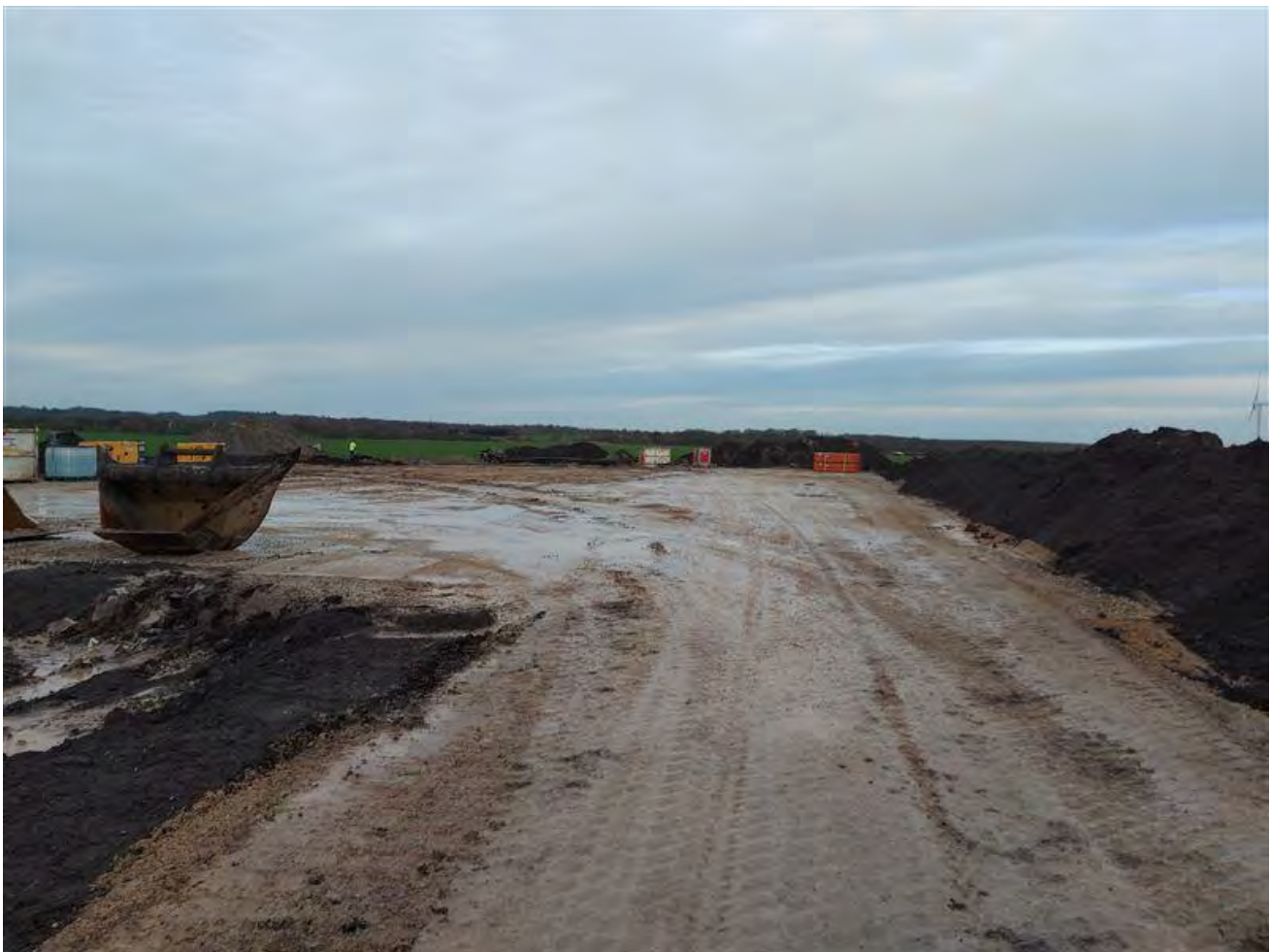
Foto: Eksempel på etablering af adgangsvej med stabilgrus og kranplads omkring en kommende vindmølle.
