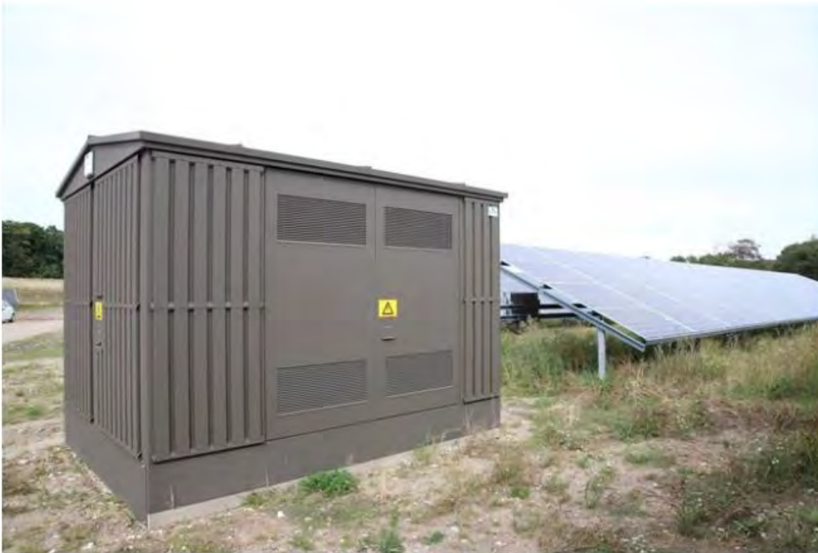
Figur 5.3.4: Eksempel på en teknikbygning, her en typisk fordelingstransformer.
