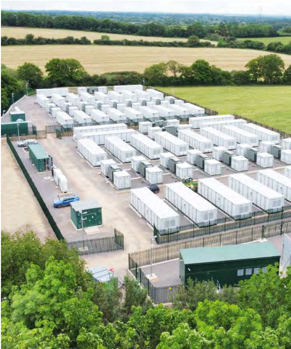
Foto: Eksempel på batterianlæg fra et andet projekt.
