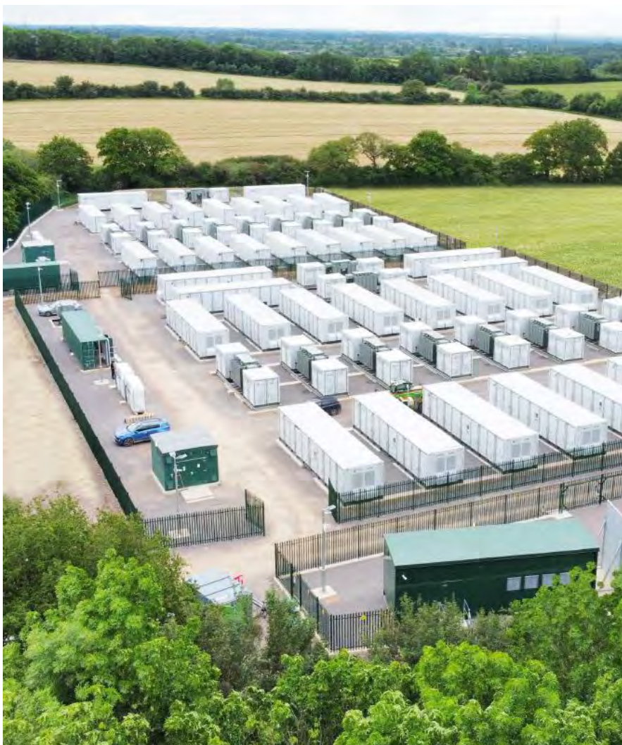
Foto: Eksempel på et batterianlæg placeret i containere.
