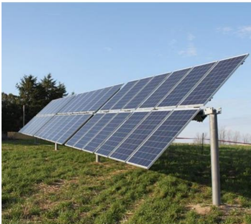
Figur 4: Eksempel på solcelleanlæg med trackersystem
